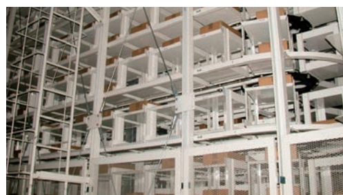
工場（自動倉庫）
